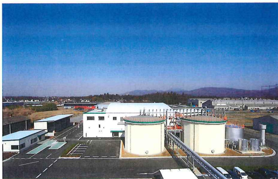
神立資源リサイクルセンター バイオプラント
